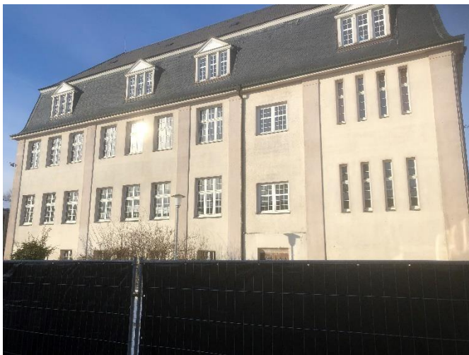
Ansicht von Süden im Ausbautzustand im Jahr 1910 – im 3. Obergeschoss befindet sich der original erhaltene Zeichensaal
